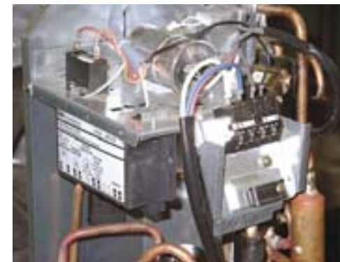
Фото 1. Пример установки регулятора
