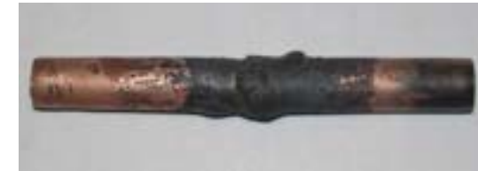
Перегретое соединение труб
